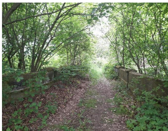
Fot. 66. Wiadukt kolejowy wymagający renowacji – obręb Siekierzyn
