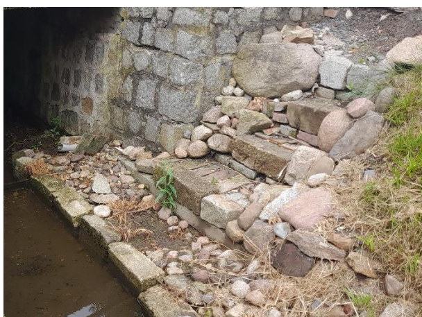
Fot. 51. Koryto cieku Lipniak wymagające odnowienia – obręb Rudzica
