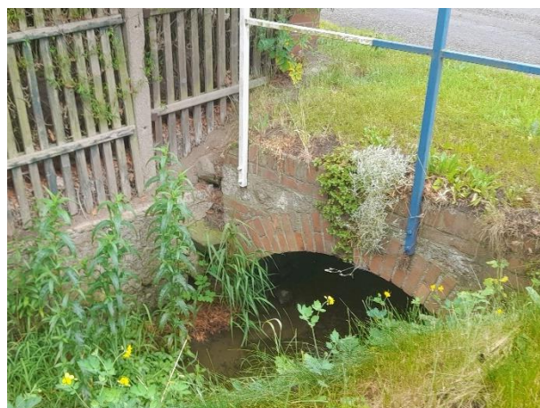
Fot. 50. Rów melioracyjny wymagający odnowienia – obręb Siekierczyn
