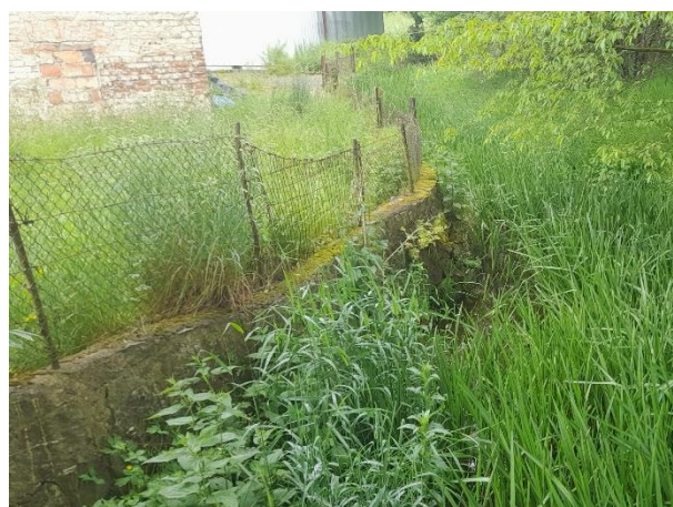
Fot. 52. Koryto cieku Siekierka wymagające odnowienia – obręb Siekierczyn
